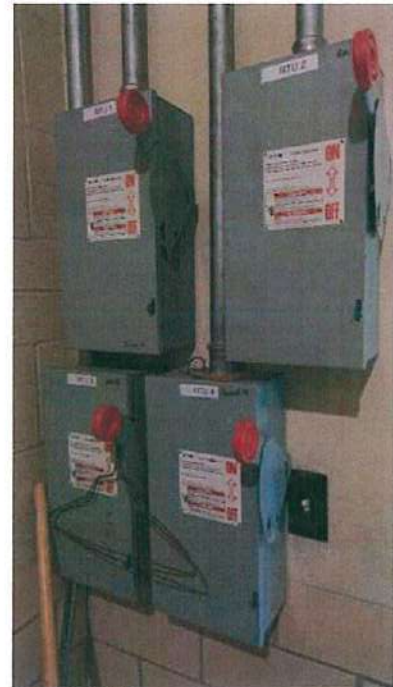
Photo E10 RTU Disconnects – Janitor 116
